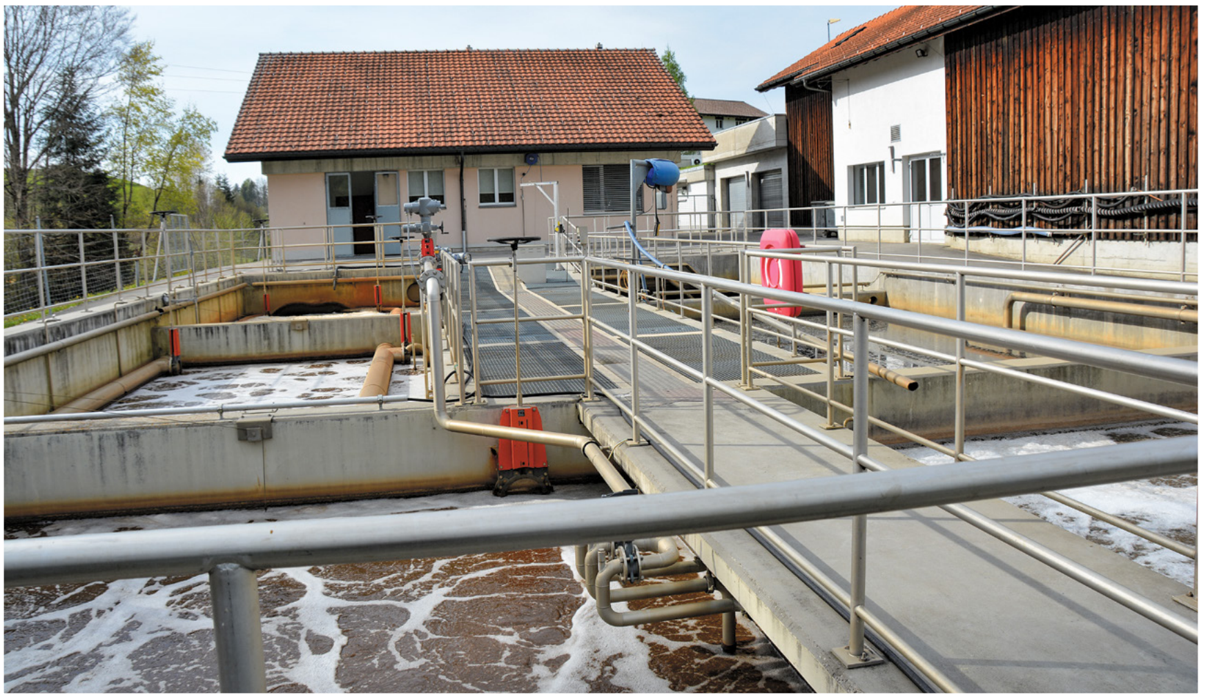
Die ARA Bühler-Gais, eine zweistufige Belebtschlammanlage, kann Abwasser von 12 500 Einwohnern reinigen.
